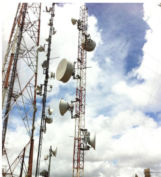
Figura 1.1 Torre com diversas antenas.
